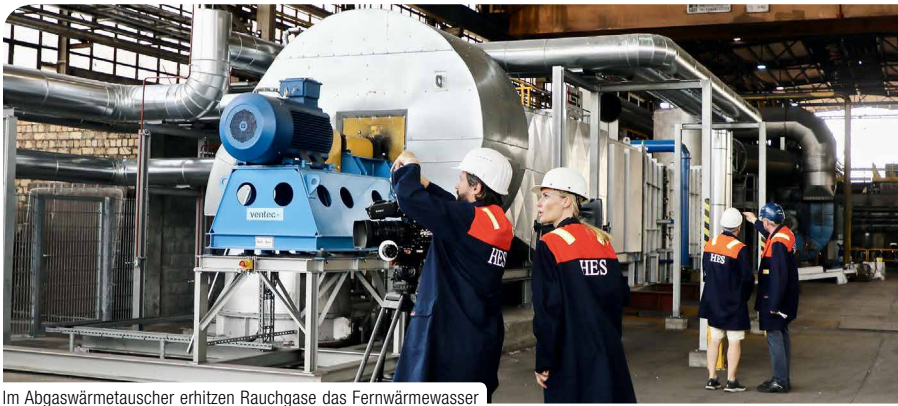
Im Abgaswärmetauscher erhitzen Rauchgase das Fernwärmewasser
