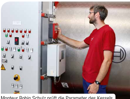
Monteur Robin Schulz prüft die Parameter des Kessels im Heizwerk Nord II
