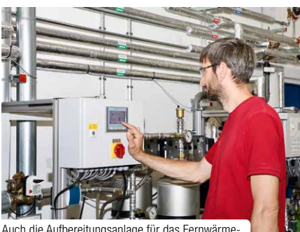
Auch die Aufbereitungsanlage für das Fernwärmewasser wird regelmäßig unter die Lupe genommen
