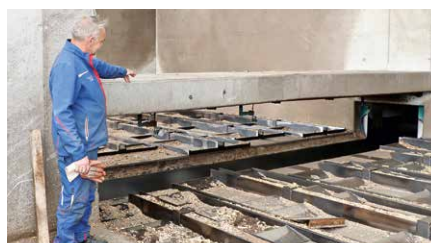
Jonathan Etert zeigt die Fördereinrichtung, über die die Holzhackschnitzel ins Kraftwerk gelangen
