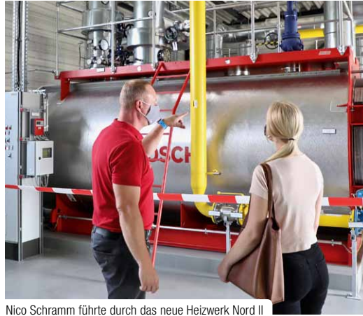
Nico Schramm führte durch das neue Heizwerk Nord II
