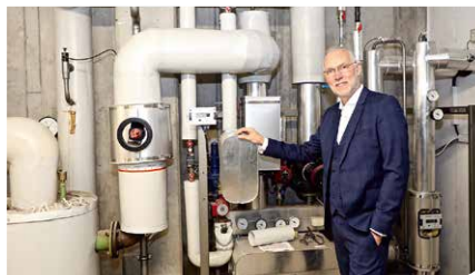
Hollidt zeigt sich begeistert: Die intelligente Fernwärmestation im V12 wird höchsten Ansprüchen des Labor- und Technologiegebäudes gerecht.
