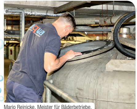
Mario Reinicke, Meister für Bäderbetriebe, prüft den Füllstand der Filteranlage
