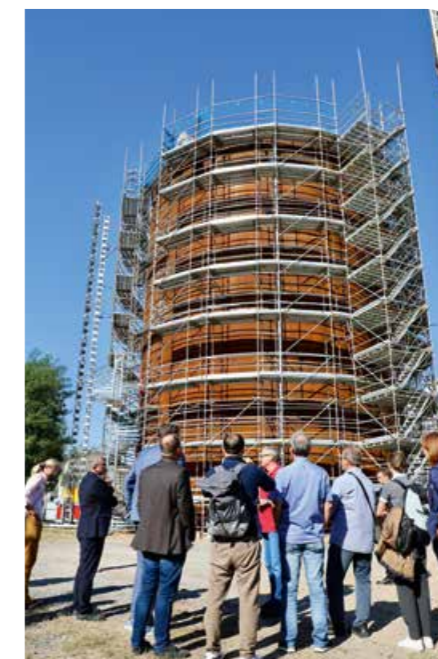
Stefan Dallorso erklärt bei der Einweihung die Funktionsweise des multifunktionalen Wärmespeichers.
