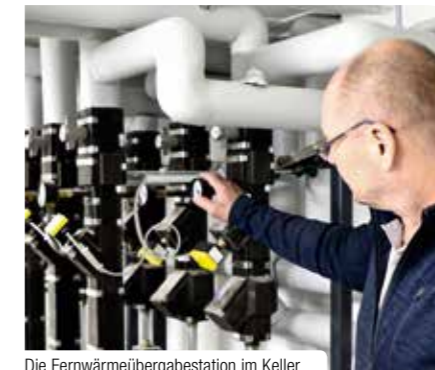
Die Fernwärmeübergabestation im Keller
